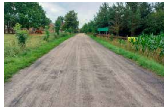
Obecny stan drogi w Borowskich Żakach, która po remoncie będzie miała nową nawierzchnię asfaltową.
