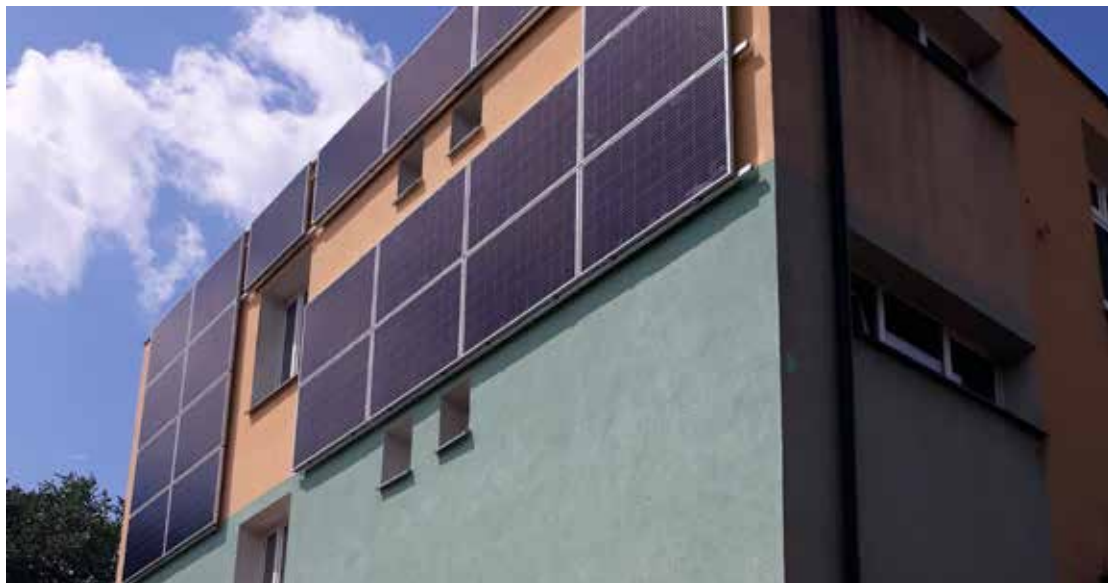
Montaż instalacji oze dofinansowany był z Regionalnego Programu Operacyjnego Województwa Podlaskiego na lata 2014-2020 z Osi Priorytetowej V – Gospodarka niskoemisyjna w kwocie – 746.574,73 zł.
