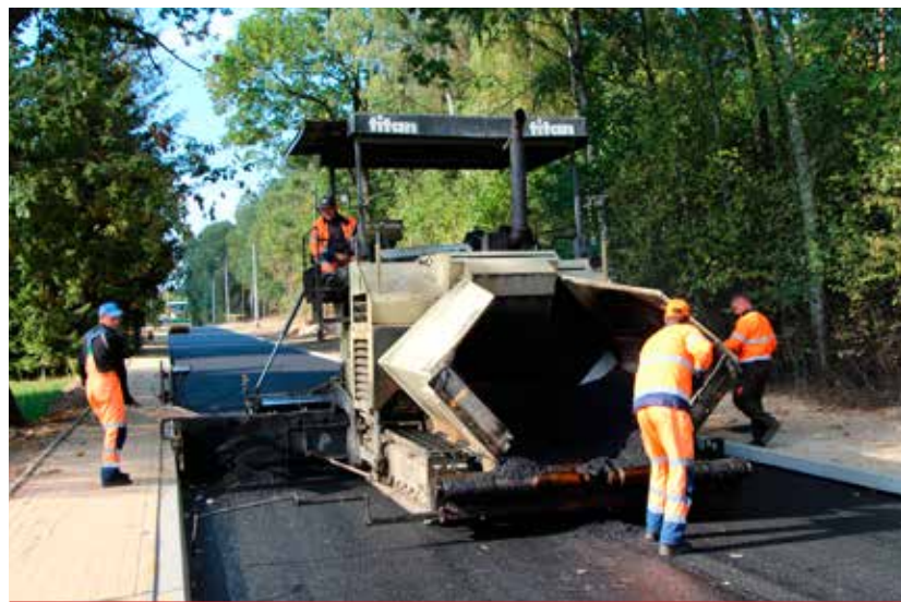
Przebudowa drogi w Niewodnicy Kościelnej na odcinku od cmentarza do granicy z gminą Choroszcz.
