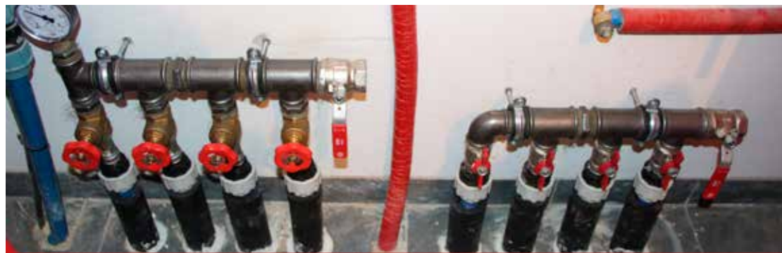
Część instalacji odbioru ciepła z gruntu.
