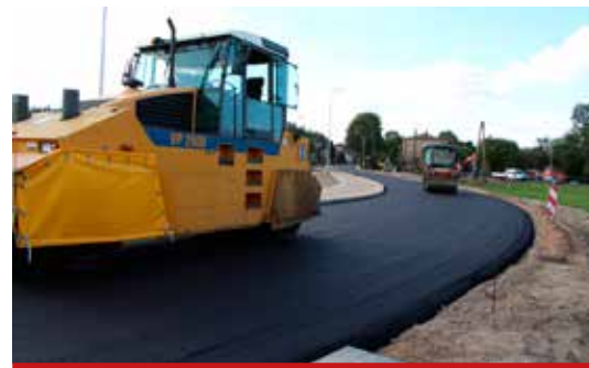
Nowy asfalt w Barszczówce to obecnie istotne przedsięwzięcie mające na celu ulepszenie stanu dróg w miejscowości.
